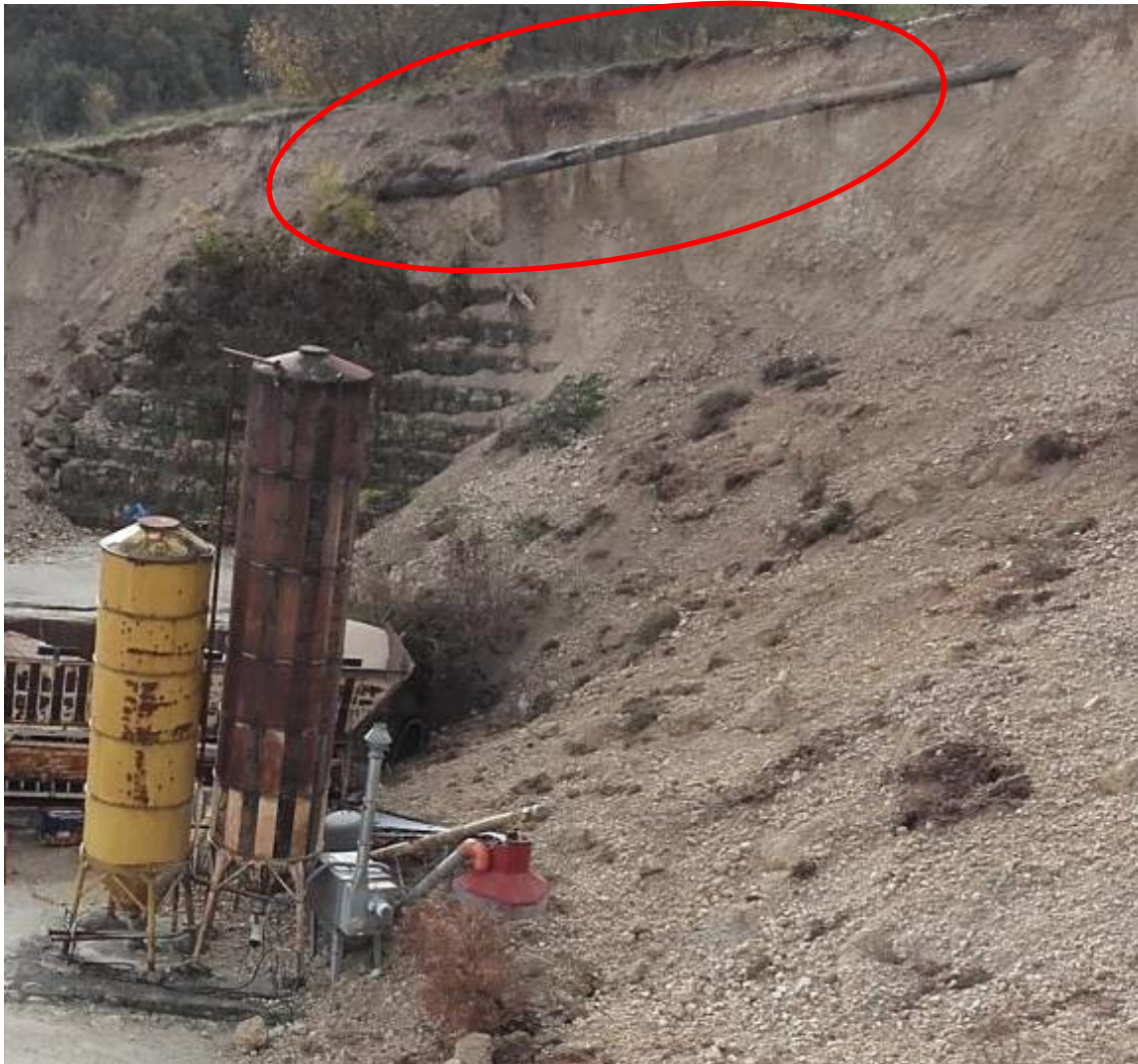
Acquedotto del Pescara, effetti del sisma 2016
