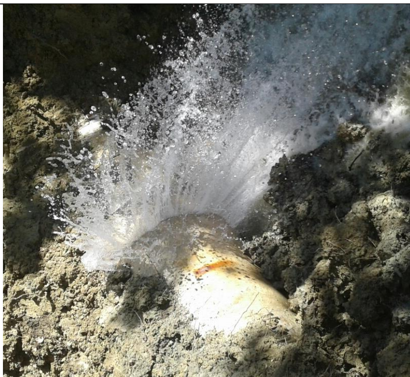
Sisma 2016: Rottura condotta Acquedotto Pescara
