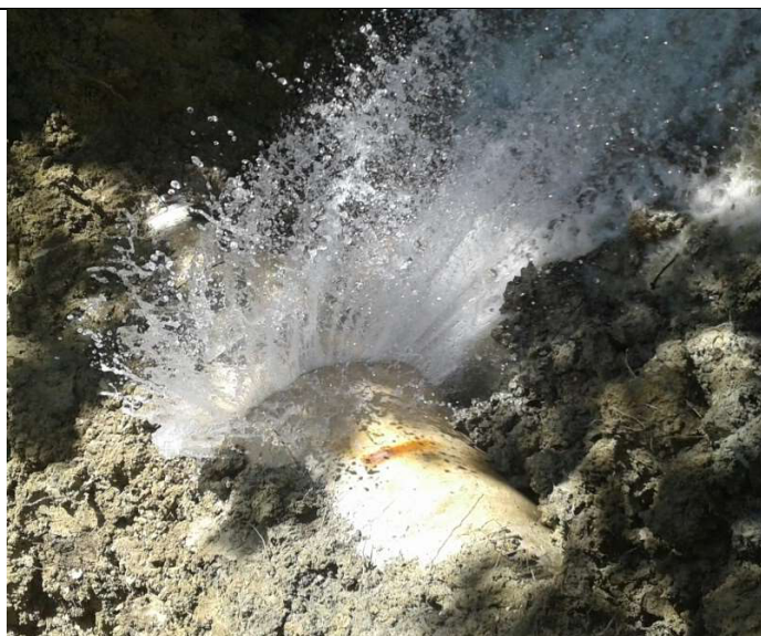
Sisma 2016: Rottura condotta Acquedotto Pescara
