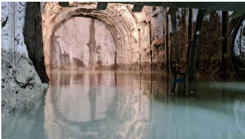
GALLERIA PESCARA PRIMA DELLA ROTTURA DELLA MEMBRANA
