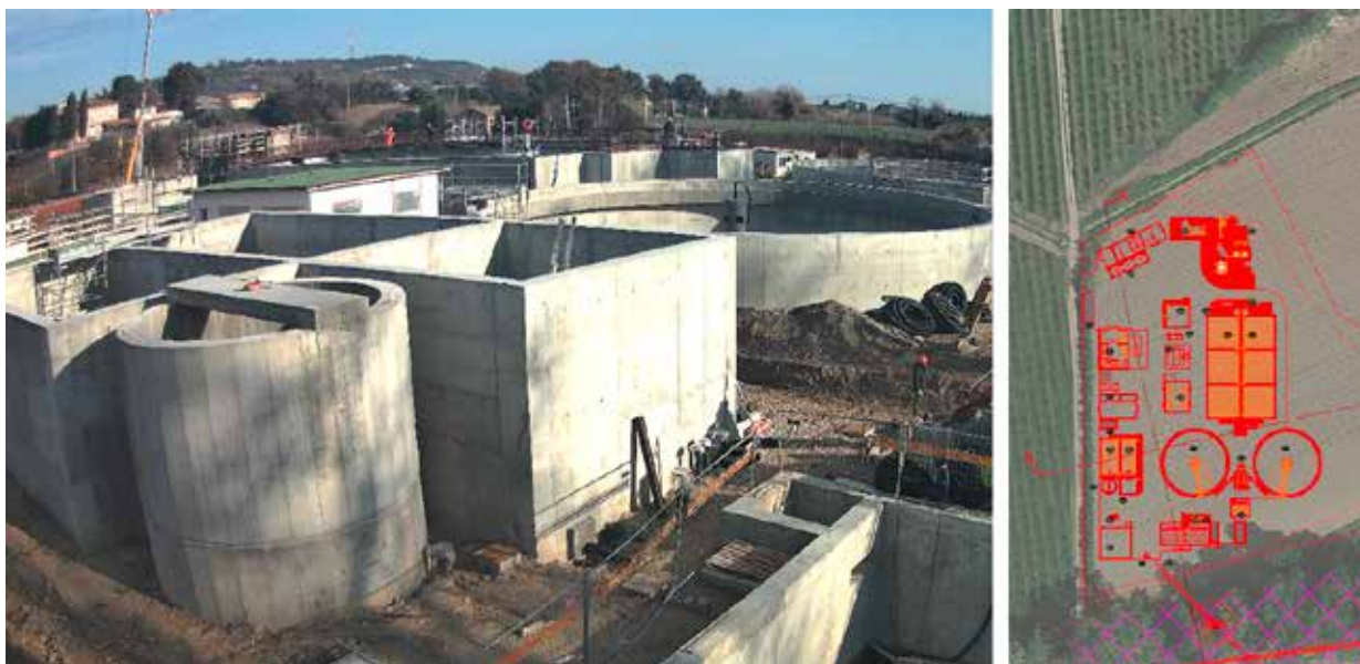
Vista da Sud-Ovest - Depuratore di Altidona_ Manufatto N014 (Post Ispessitore) N09 (Vasca Accumulo Fanghi) e N14 (Vasca invarianza)
