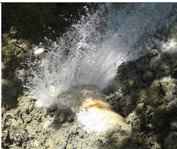
Sisma 2016: Rottura condotta Acquedotto Pescara
