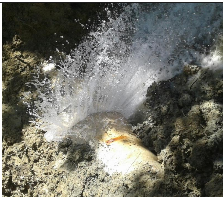
Sisma 2016: Rottura condotta Acquedotto Pescara
