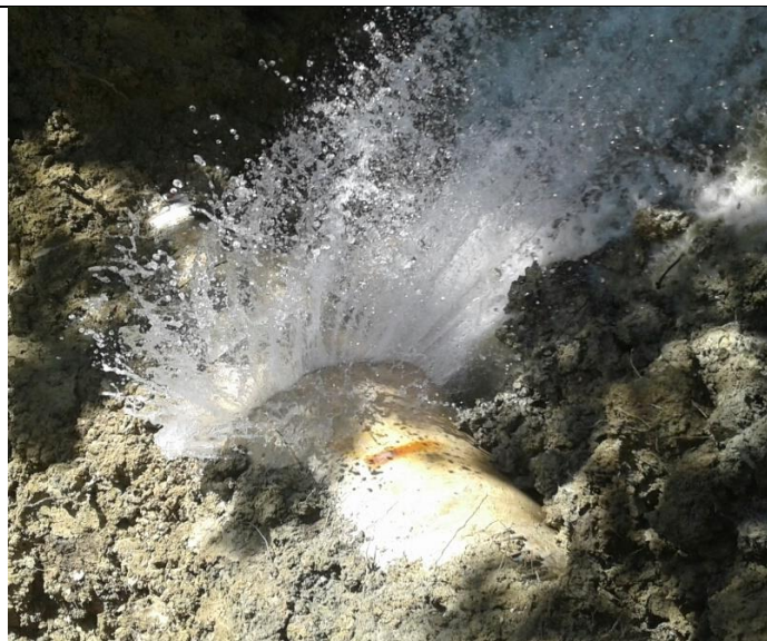
Sisma 2016: Rottura condotta Acquedotto Pescara
